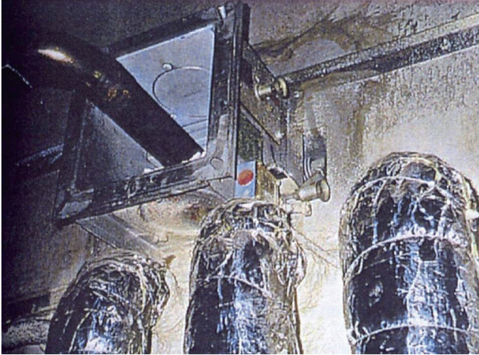
Abb. 0.1: Rohrleitungsdurchführung durch eine Brandschutzklappe, die im Brandfall niemals bestimmungsgemäß schließen kann [1, S. 97]
